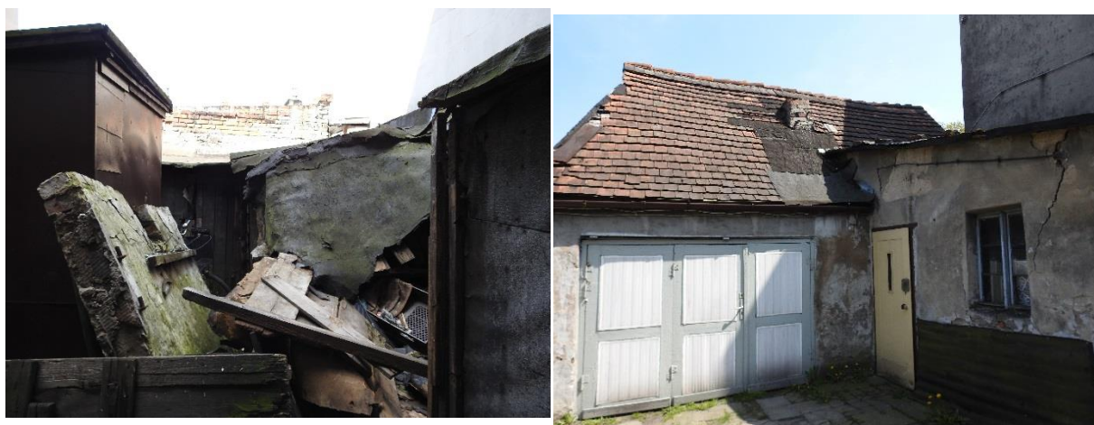
Zdjęcie 21. Zdewastowane budynki
